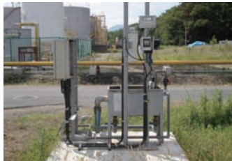
雨水排水監視槽
