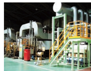
ボイラ室全景
