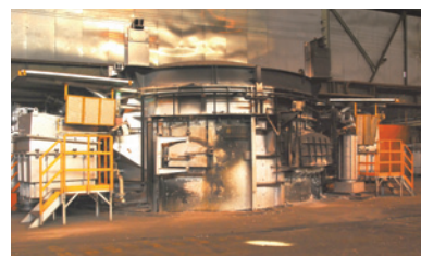
燃料転換した溶解炉
