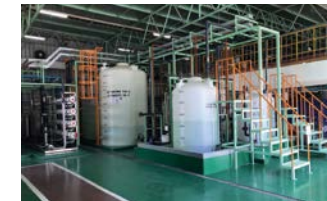
水リサイクルの設備
