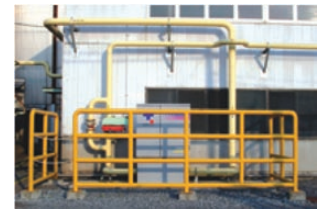
パイプライン接続口(深谷工場)
