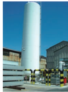
LNGタンク基地(日光工場)
