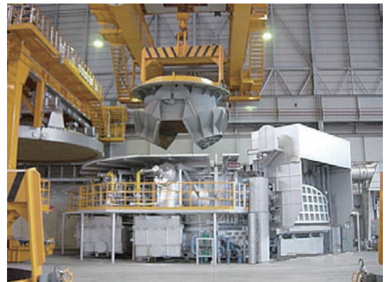
図6 リジェネバーナ採用の高性能溶解炉 Fig.6 High-efficiency melting furnace using regenerative burners.
