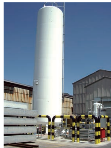
図7 LNGタンク基地（日光工場） Fig.7 LNG station. (Nikko Works)
