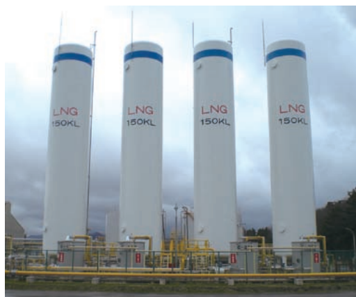
図4 LNGタンク基地(福井工場) Fig.4 LNG station. (Fukui Works)
