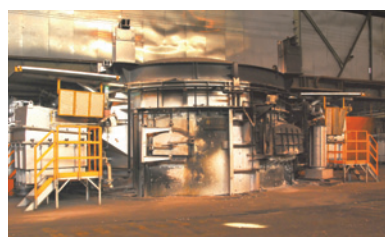
燃料転換した溶解炉
