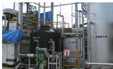
洗浄廃液処理装置
