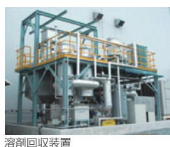
溶剤回収装置
