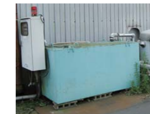
地下水浄化装置
